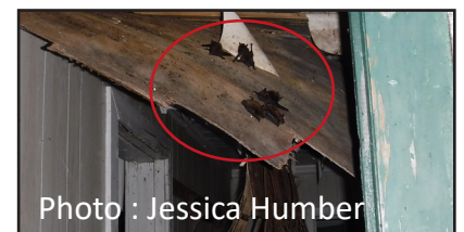
Figure 1. Certains bâtiments doivent être démolis pour garantir la sécurité publique ce qui ne permet pas aux chauves-souris de rester.
